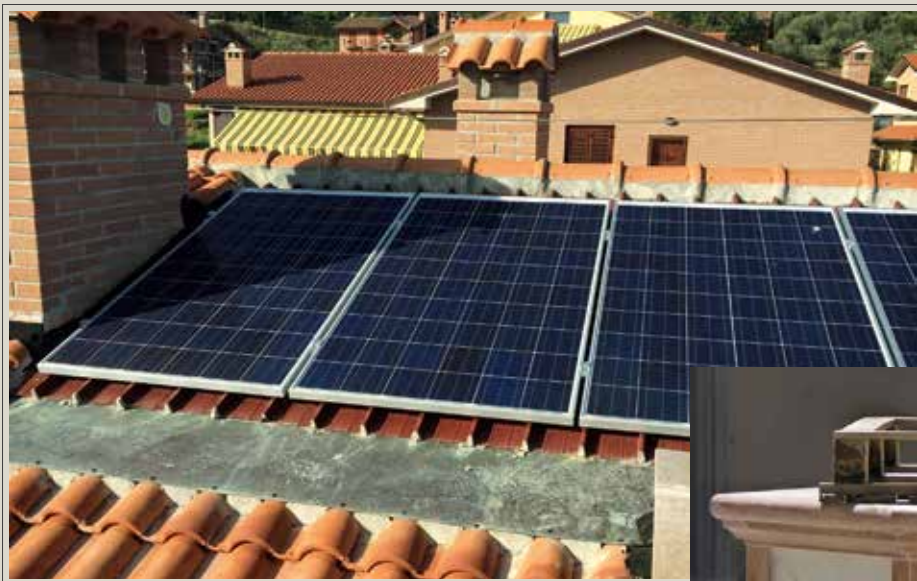
Impianti con pannelli fotovoltaici
